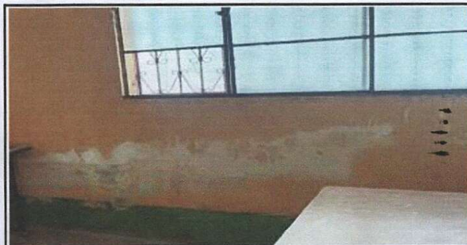
Foto 6: REPELLO EN MAL ESTADO
