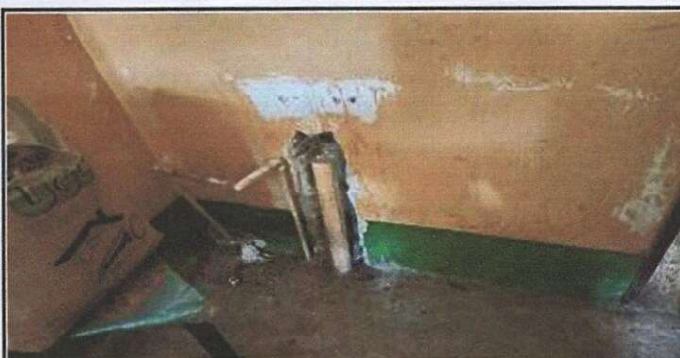
Foto 5: RED DE AGUA Y DRENAJES EN MAL ESTADO
