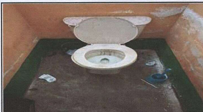
Foto 4: BAÑOS EN MAL ESTADO
